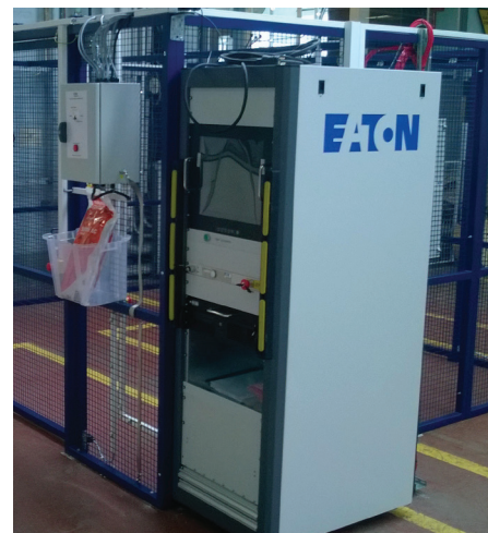
Kontroll- und Messeinschub
